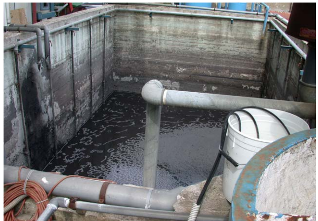
Vasca di raccolta reflui di conca – Solofra (AV).
