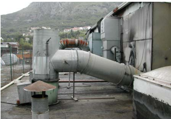
Impianto di depurazione delle emissioni – Solofra (AV)
